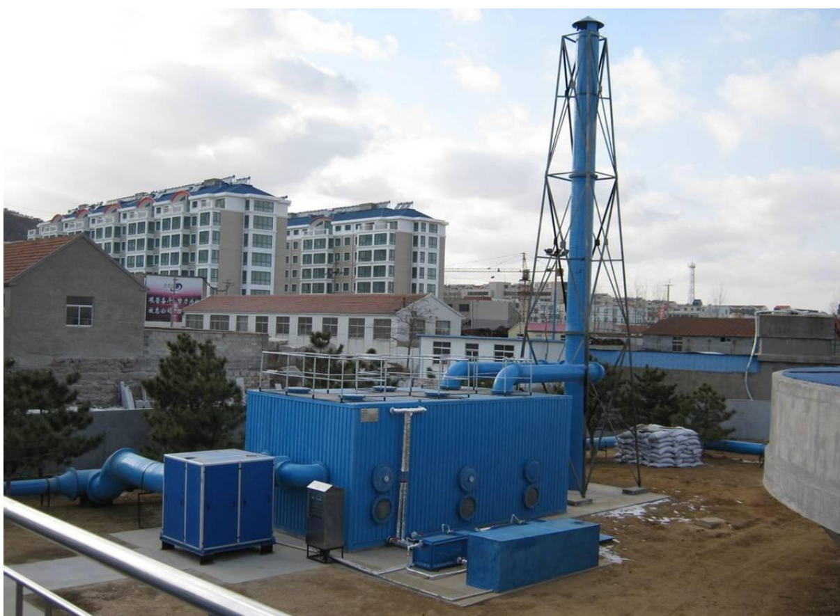
图 7.2-3 某污水处理厂生物除臭实例
