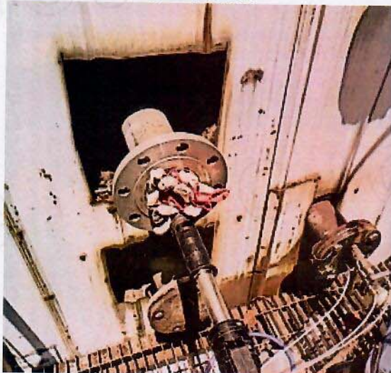
2#机组废气排放口（有组织）
