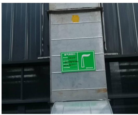
水转印和往复式喷漆室废气排口（DA004）标识
