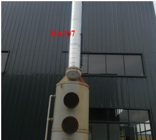
抛光废气喷淋塔
