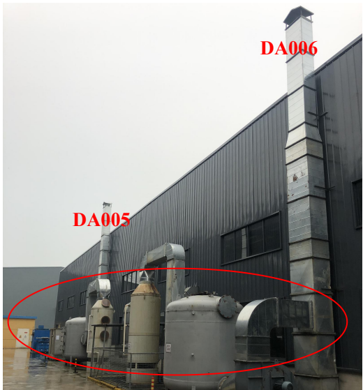
水喷淋+UV 光解+15m 排气筒
