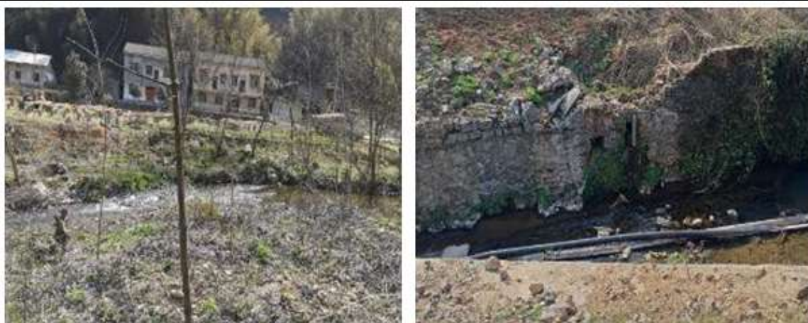
岸坡冲刷不稳照片
